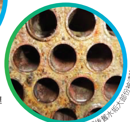
安裝處理器前管道上的水垢
